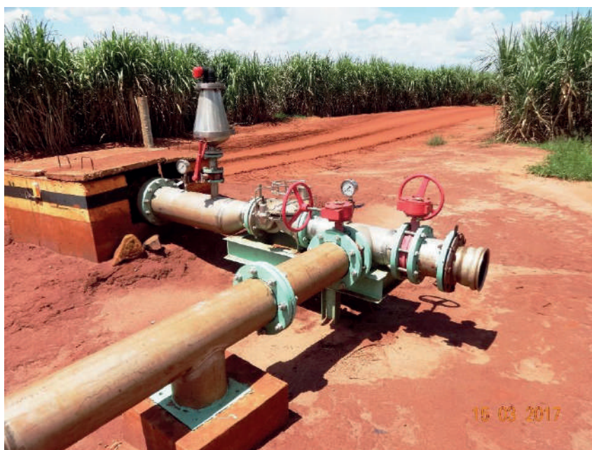
Figura 46 - Válvula redutora de pressão
