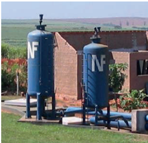
Figura 30 - Reservatório Hidropneumático - RHO (Balão)
