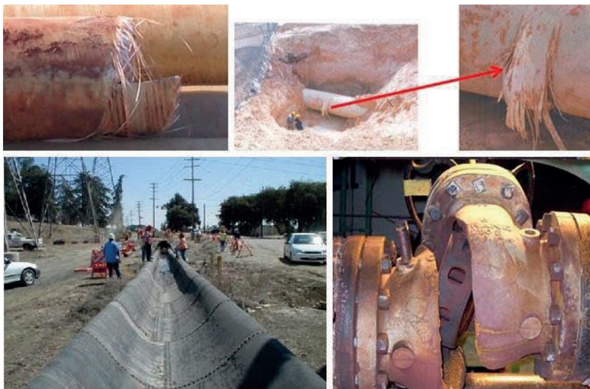
Figura 23 - Danos causados pelo golpe de aríete em tubulações e acessórios sem proteção
