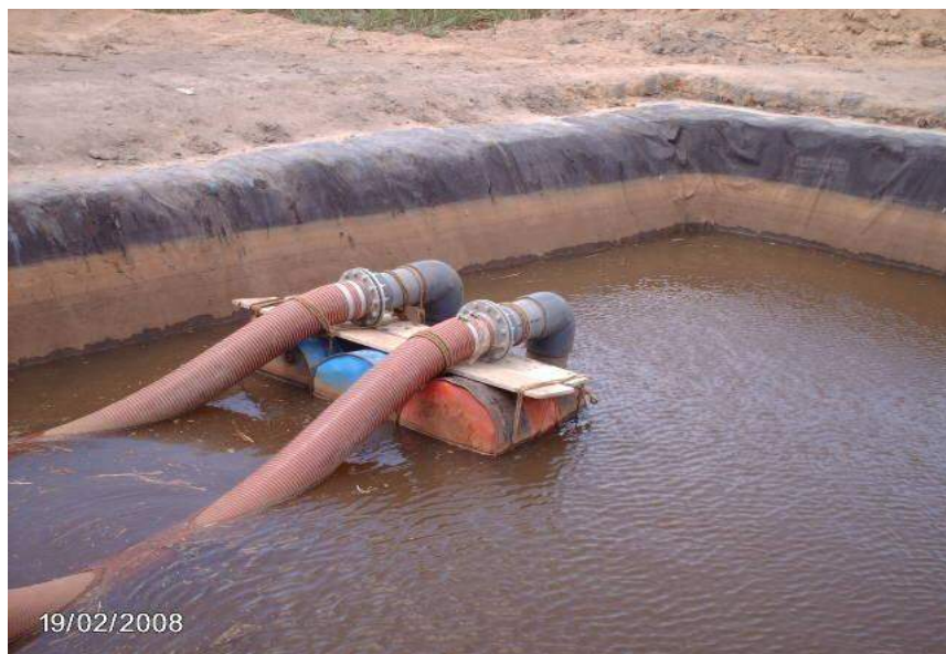
Figura 105 – Sucção flutuante em tanque revestido.
