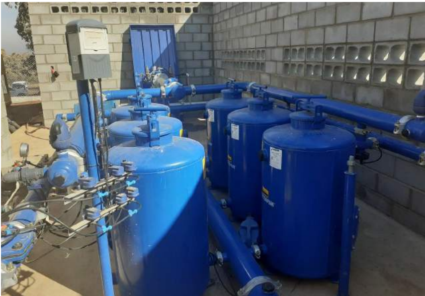
Figura 87 - Conjunto de filtragem de areia em Ribeirão Preto (Foto: Daniel Pedroso).
