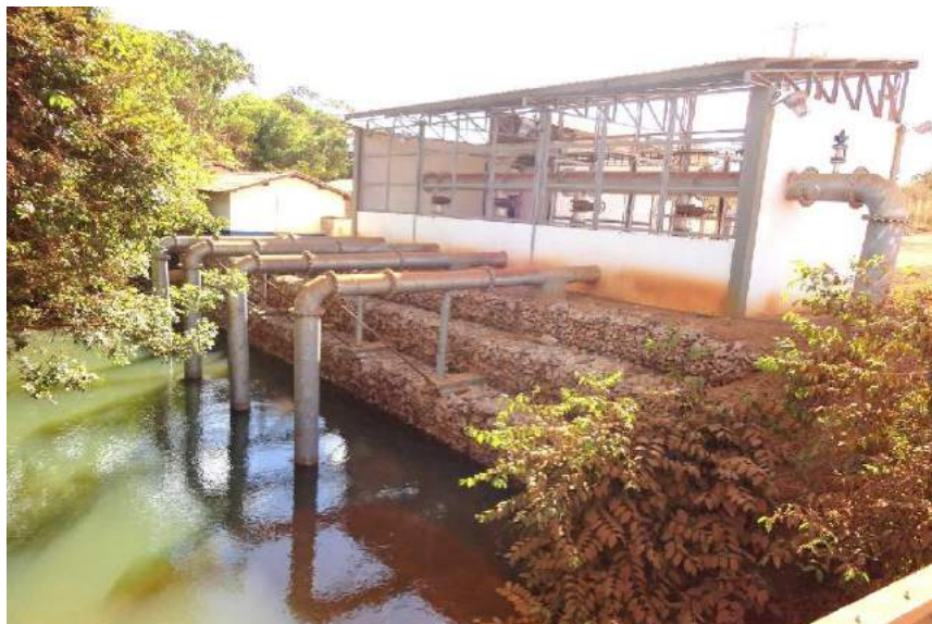
Figura 103 – Sucção negativa de captação de água.
