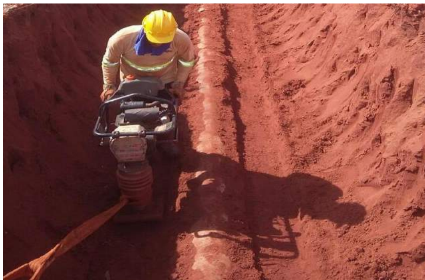
Figura 113 – Tubulação de PRFV + PVC (Foto: IrrigaEngenharia).
