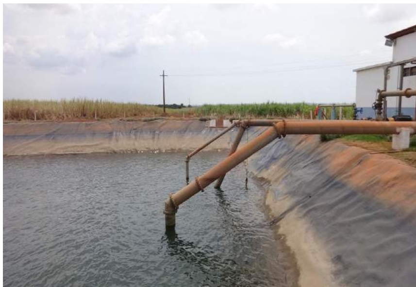
Figura 104 – Sucção negativa de captação de água em tanque revestido.
