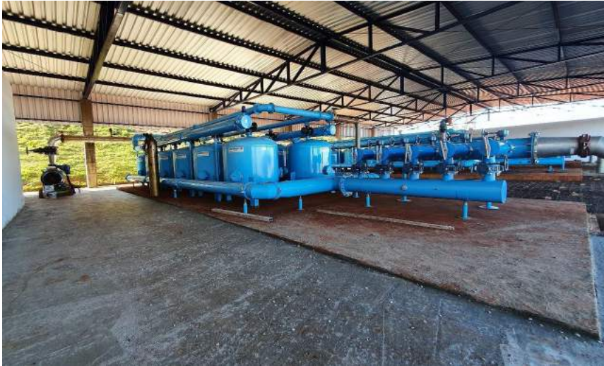
Figura 86 - Conjunto de filtragem de areia em Ribeirão Preto (Foto: NaanDanJain).
