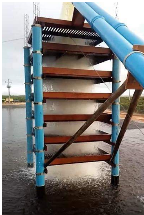
Figura 88 - Reservatório de sedimentação com aerador para pré-tratamento da água (Foto: NaanDanJain).
